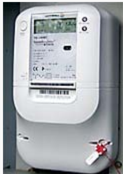
Boxen med GPRS-Sändare och PLC System
